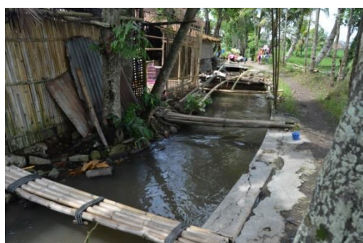
Gambar 4 Longsor pada R. KN. 2 pada DI Kenari
