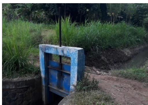
Gambar 5 Longsor pada B. MR. 10 pada DI Mrawan
